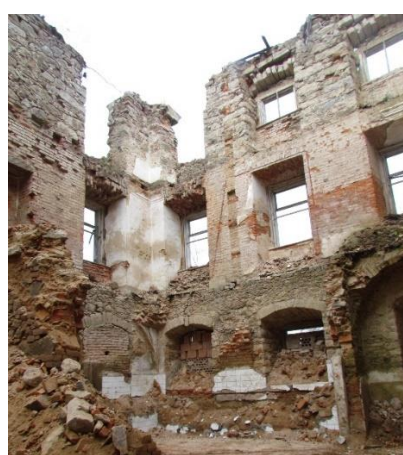
Po vyklizení zbyly mnohde jen obvodové zdi
