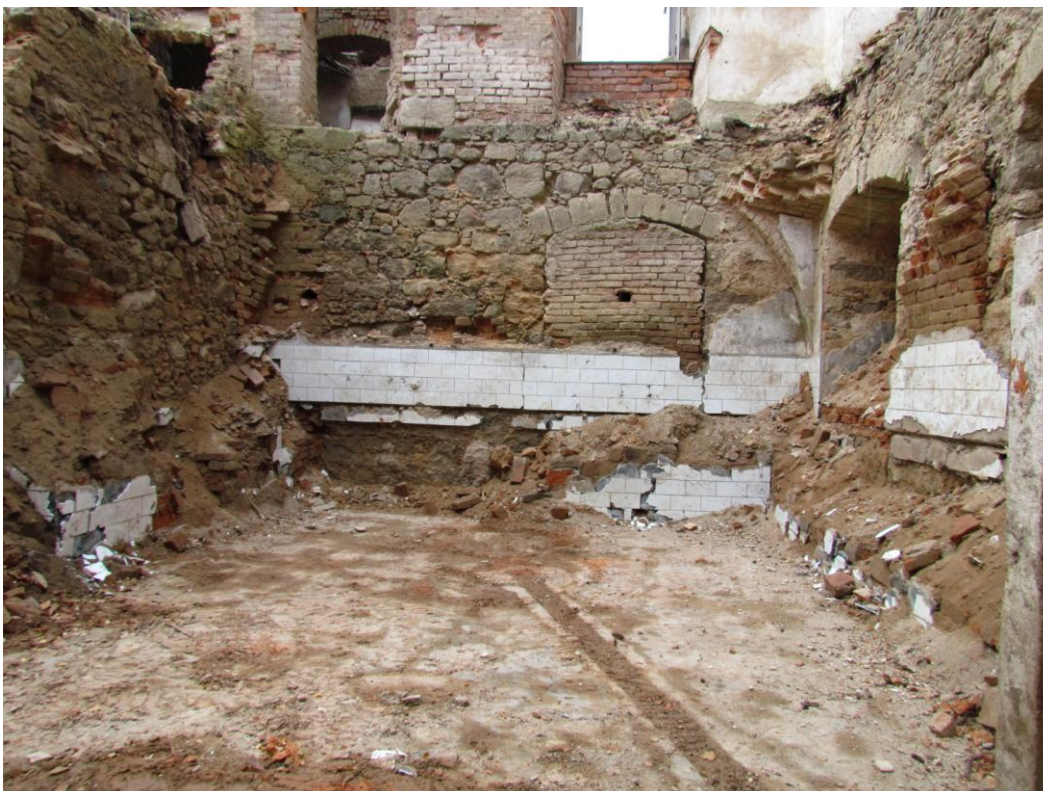
Stav po vyklizení takřka třímetrového nánosů suti v této části objektu
