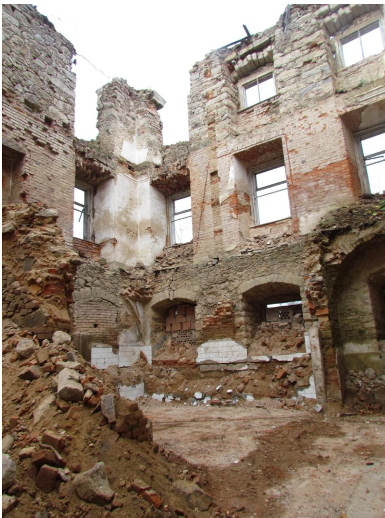
Stav po vyklizení staticky narušených a zřícených stavebních konstrukcích severovýchodního křídla zámku
