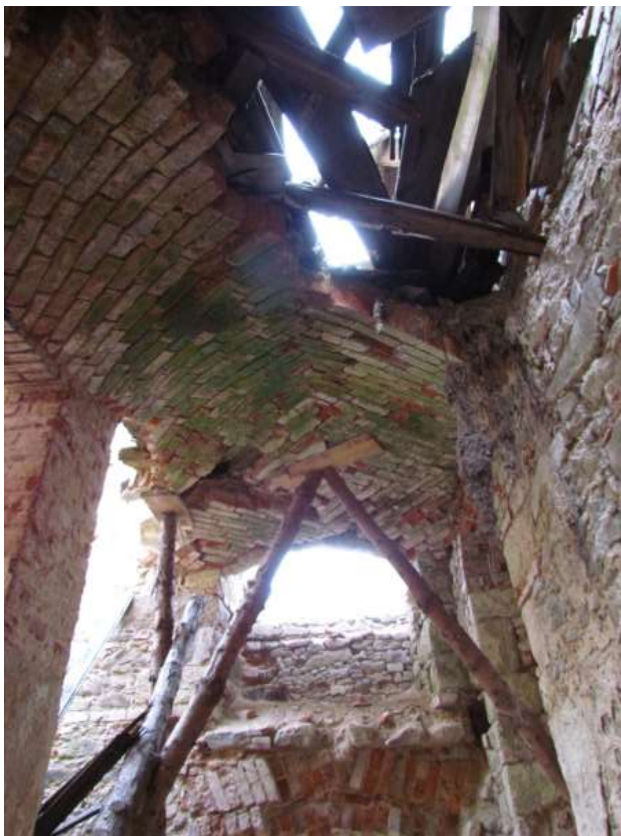
Aktuální stav kleneb hlavního schodiště v III.NP Pokud nedojde k okamžité sanaci, hrozí degradace celého hlavního schodiště. Akutní havarijní stav
