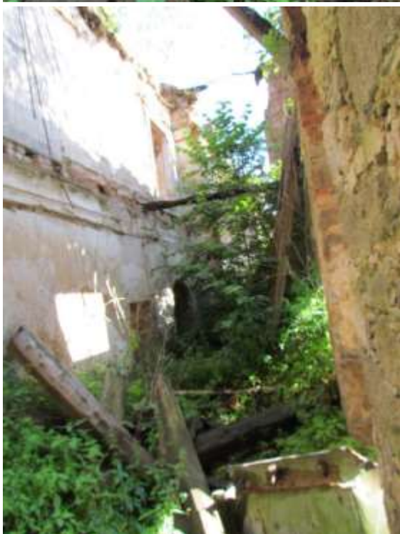
KATASTROFÁLNÍ STAV OBJEKTU ZÁMKU V ROCE 2011
